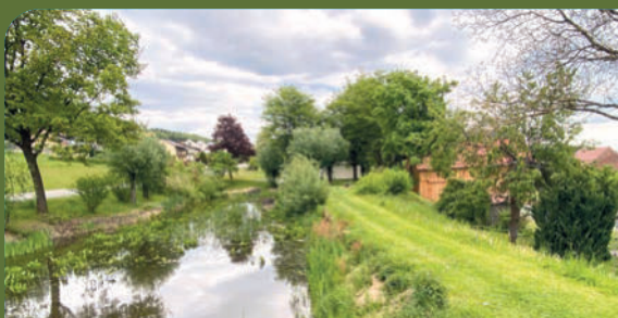
Der instabile Damm des Brauweihers muß gesichert werden.
