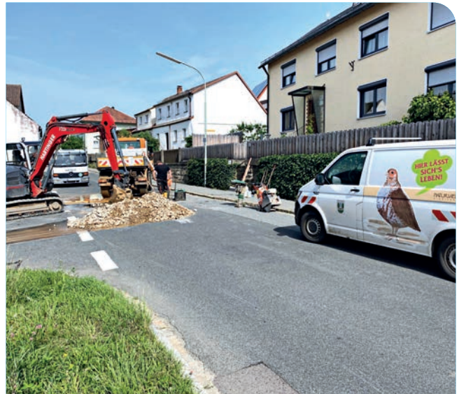
Schadenstelle im Mündungsbereich „Oberviechtacher Straße/ Brauhausgasse
