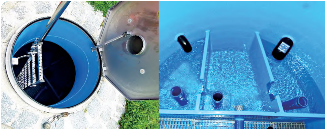
Abb. 5 und 6: 2014 erneuerte Quelfassungen, hier: Vogelquelle. links: Schmutz- und wasserdichte Schachtabdeckung rechts: Blick in den sauberen Sammelschacht, von links Kochlöffelquelle kommend, von rechts Vogelquelle kommend, mittig: Ableitung zur nächsten Quelle. (Fotos: L. Kroll, 2021)
